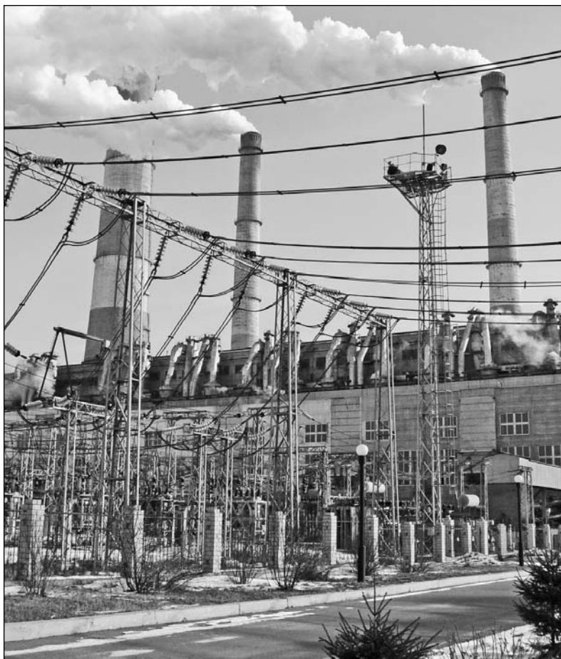
ТЭЦ-9 ОАО «Иркутскэнерго»
